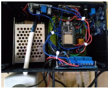
Gambar 10 Komponen pada box elektronik
